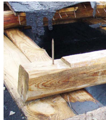
Zdj. 2. Fragment więźby z wyrwanym gwoździem krokwiowym.
