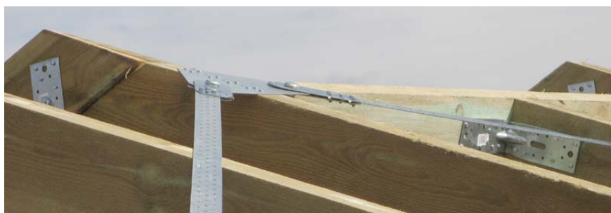
Zdj. 4. Element systemu stężenia dachu – blacha węzłowa.
