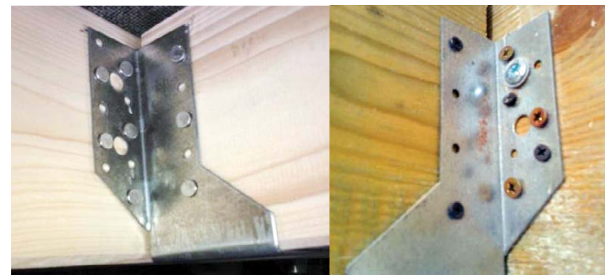
Zdj. 10. Niepoprawne połączenia – zły typ łączników i błędne ich rozmieszczenie
