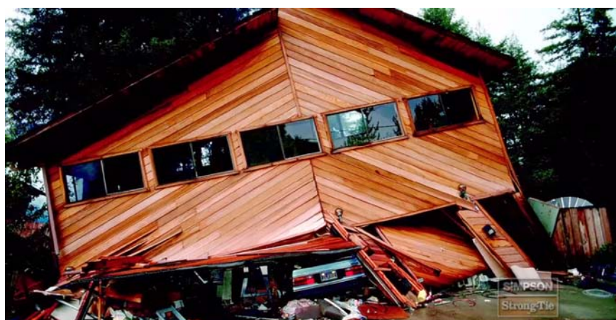
Fot. 2. Zniszczenie domu na skutek utraty sztywności.
