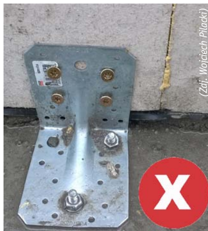
Fot. 4. Niepoprawne kotwienie przez warstwę poszycia.
