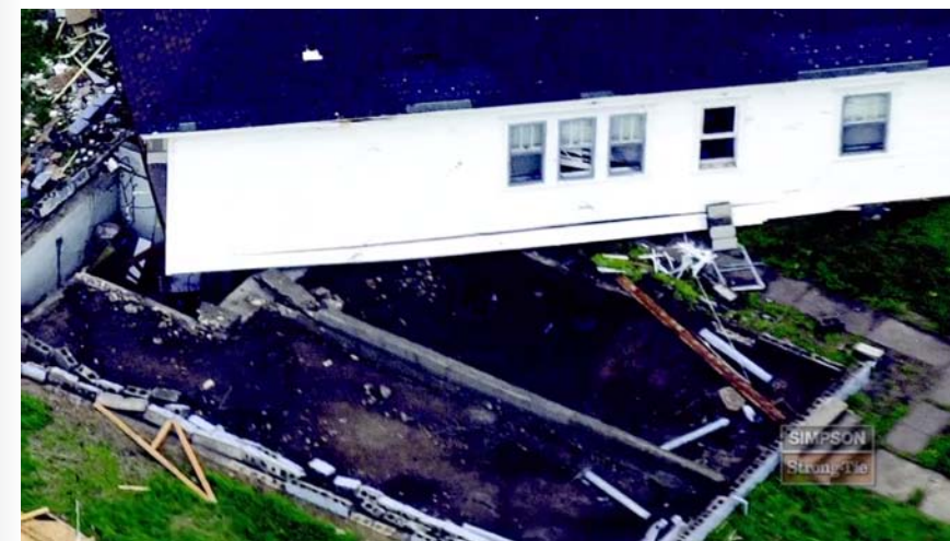
Fot. 2. Zniszczenie budynku przez przesunięcie.
